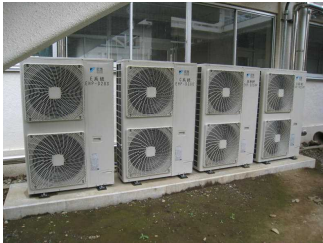
理科室北の室外機
